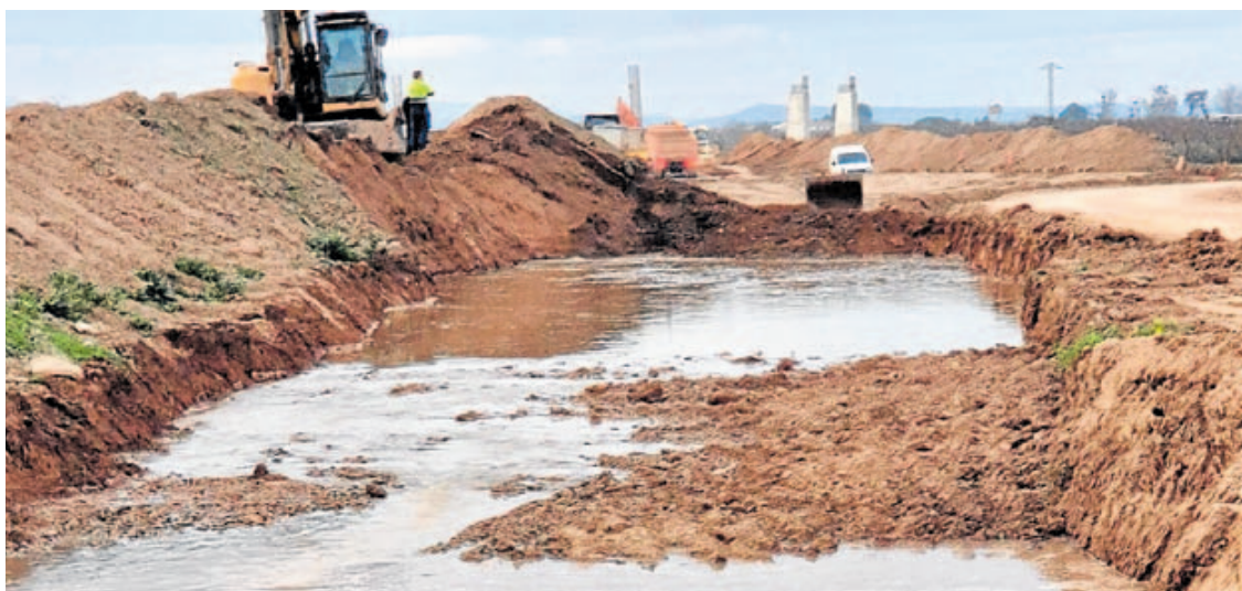
Inundación provocada por la rotura de la tubería de agua en la variante del tren en Rincón. AYUNTAMIENTO
